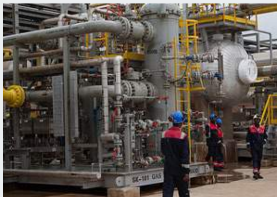
Usine de traitement de gaz d'Atuabo au Ghana 52
