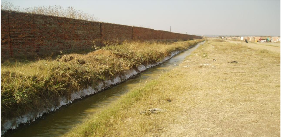
Une croute blanchâtre sur les drains de CHEMAF
